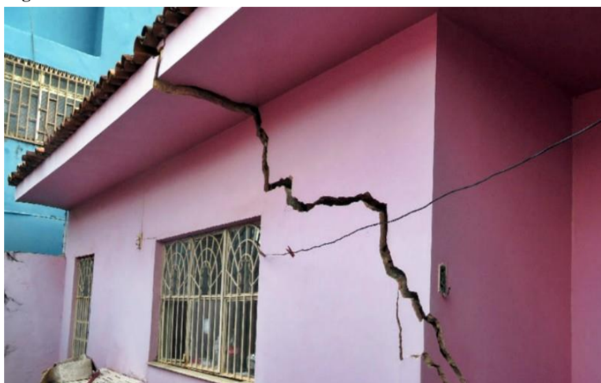
Figura 5: Rachadura em residência localizada no bairro do Pinheiro.
